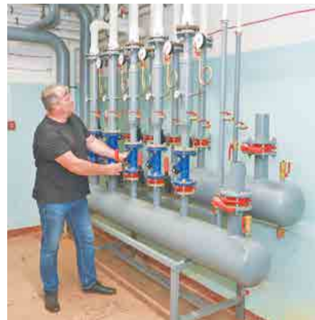
Начальник тепло-сантехнического участка ОГЭ Владимир Зуев возле нового теплового узла в корпусе №28, где располагаются склады ЦСС.
